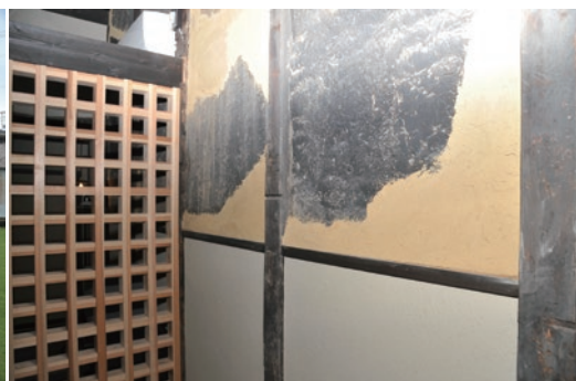
築約150年の長屋の歴史を感じられるように、改修でほぼ手をつけなかった土壁も
